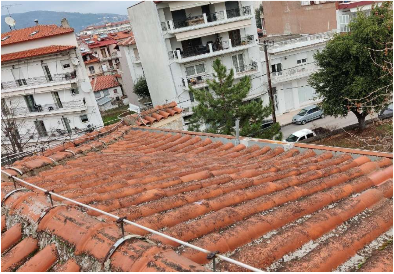
Εικόνα 4: Φθορά - καθίζηση στέγης ανατολική όψη
