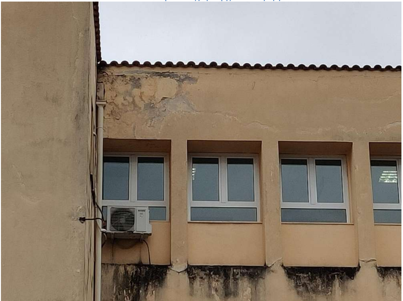
Εικόνα 5: Φθορά στη συναρμογή με την κατακόρυφη υδρορροή
