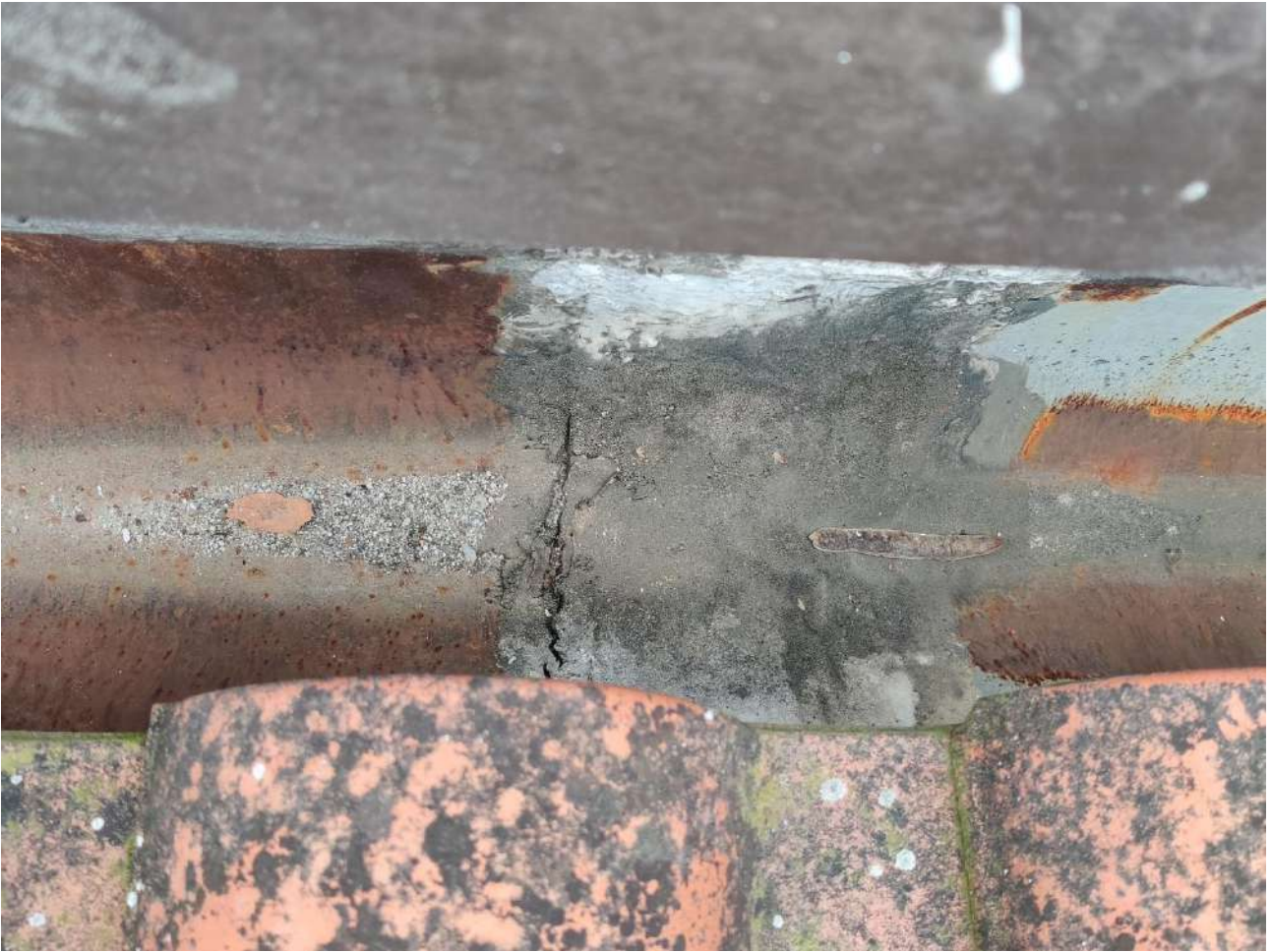
Εικόνα 2: Ενδεικτική κατάσταση οριζόντιας υδρορροής
